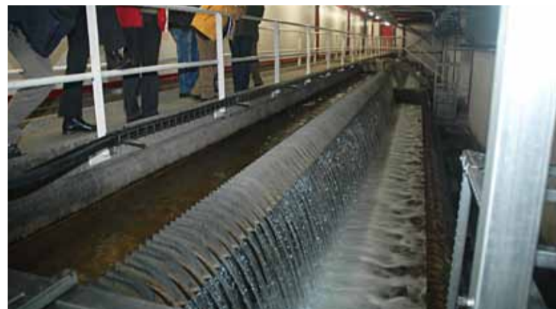
Het water wordt via watervallen (cascades) naar snelfilters gepompt, om ijzer- en mangaandeeltjes te verwijderen en ook het poederkool dat bij een eerdere zuiveringsstap is toegevoegd.
